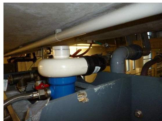
Raccordement de la sortie de l'eau préchauffée
