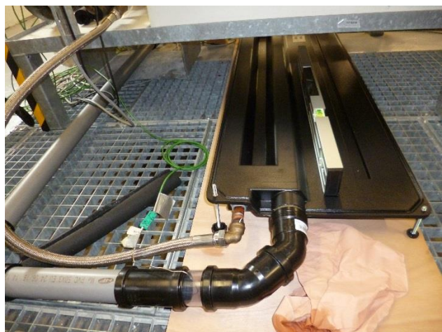
Raccordements de l'entrée d'eau froide et de la sortie des eaux de douche
