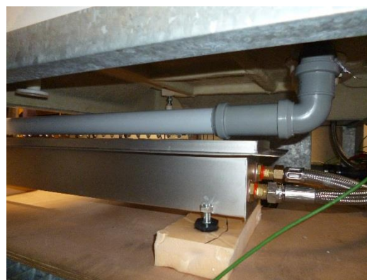
Alimentation de l'échangeur en eaux de douche via un tuyau d'alimentation perforé
