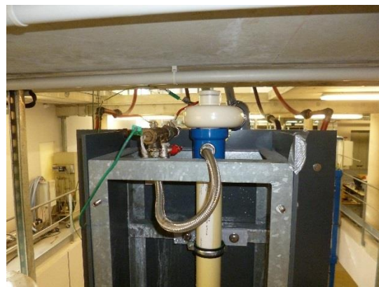
Raccordement de la sortie de l'eau préchauffée
